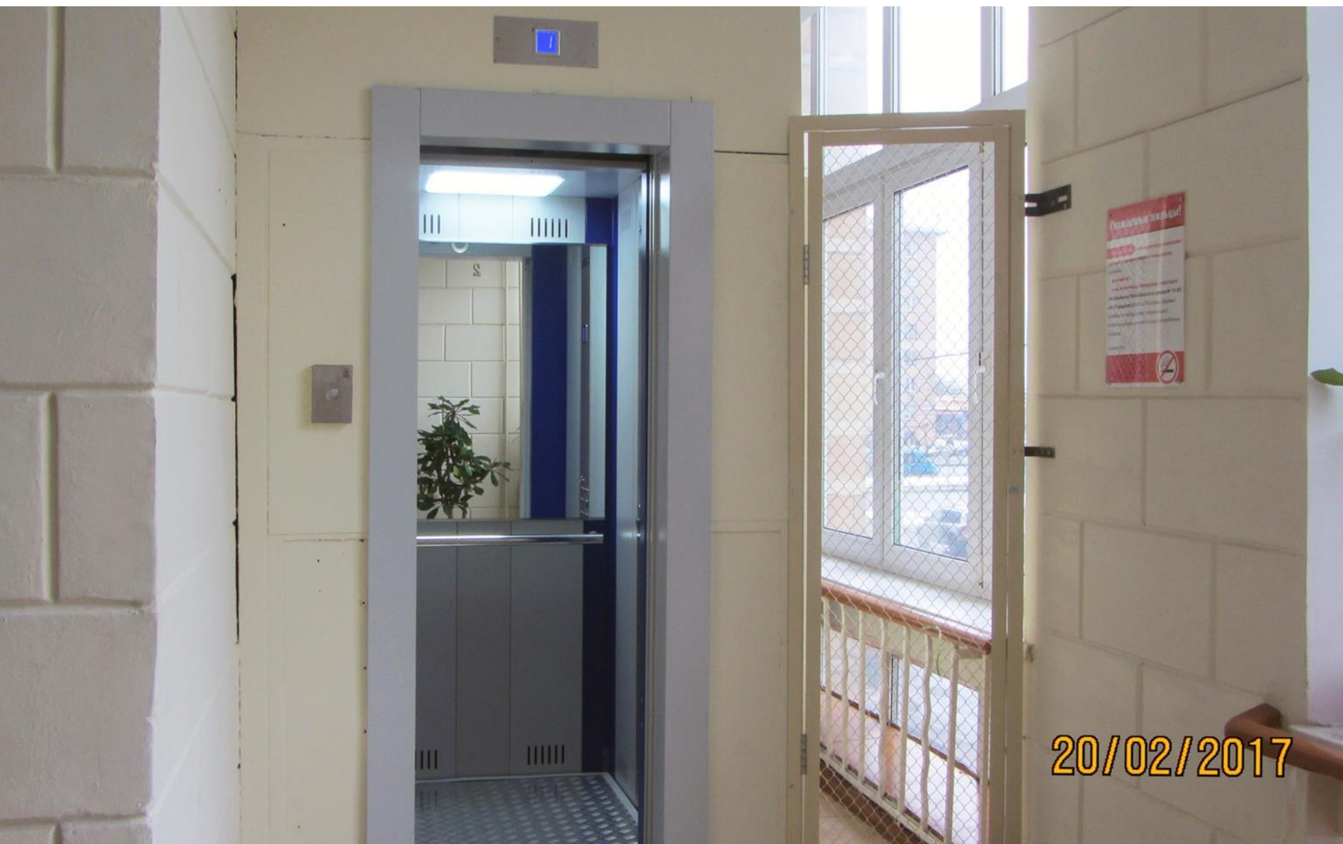
2017 г. Новый лифт в 8 подъезде
